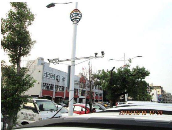
圖十三 建置錄影監視系統(CCTV)
