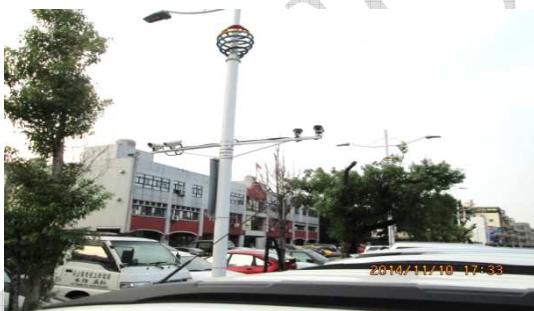
圖十三 建置錄影監視系統(CCTV)
